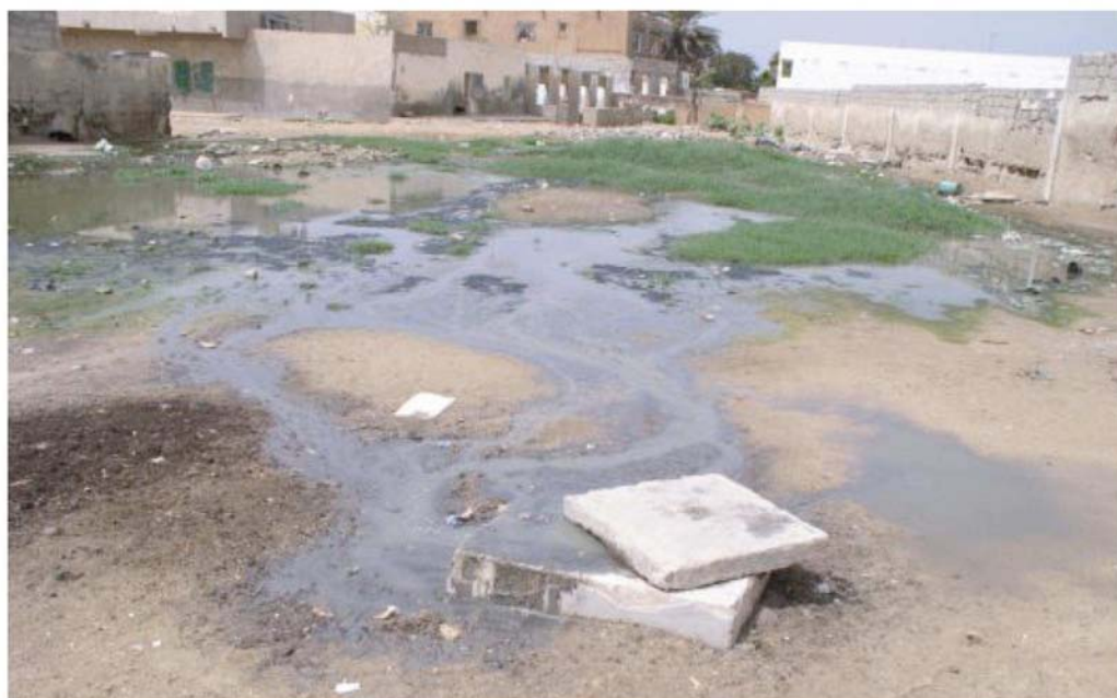
Photo III.2.4 : Rejet d'eaux usées à partir d'un regard situé dans le secteur d'Arafat-Castors : une illustration des limites techniques des réalisations ENDA-RUP
