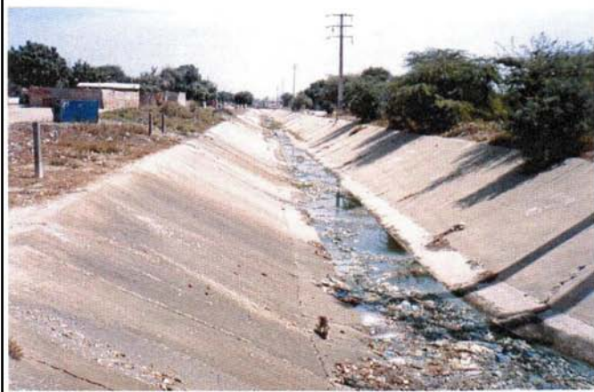
Photo I.2.11 : Eaux usées et ordures dans le canal de Ceinture
